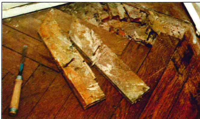
7 Durch den Echten Hausschwamm geschädigtes Parkett
